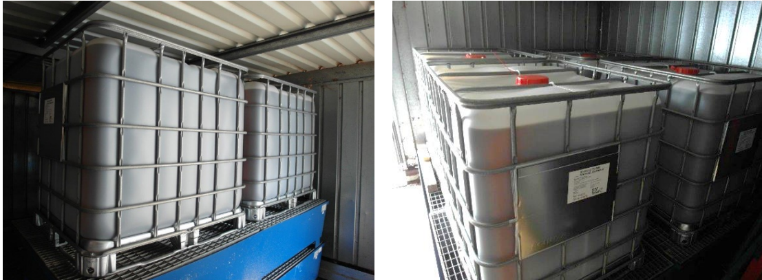
Abbildung 4-16 und Abbildung 4-17: Kraftstofflager für B100
