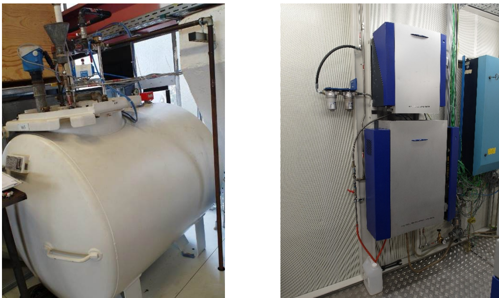
Abbildung 4-18 und Abbildung 4-19: Tagestank am Motorprüfstand und Kraftstoffwaage mit Kraftstoffkonditionierung
